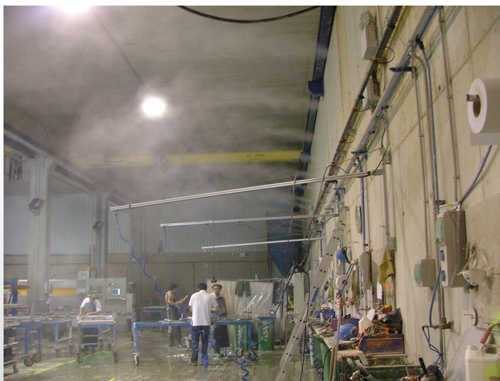
SISTEMA FIC—FOG - NEUTRALIZACIÓN DE POLVO EN MARMOLERÍA
