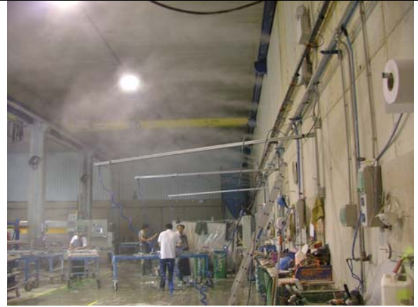
Ramal de 18m de longitud con boquillas de nebulización FICFOG neutralizando al 98% el polvo ambiental generado.
