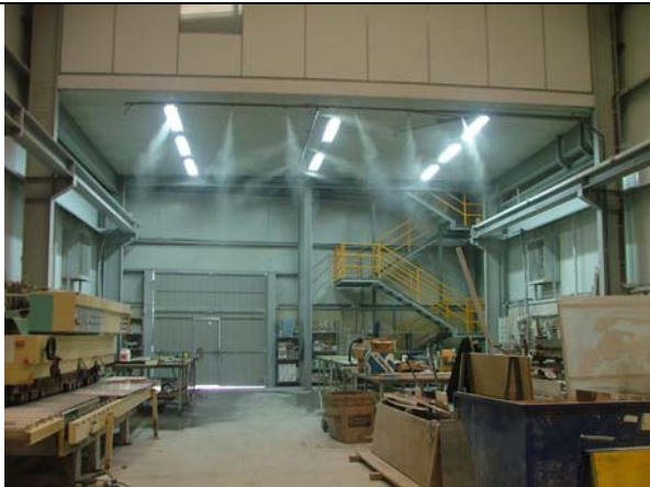
Instalación nebulización a 8m de altura para neutralizar polvo y partículas en suspensión en zona de 8m x 7m – Industria procesado Mármol – Cuarzo aglomerado y resinas – Granitos.
