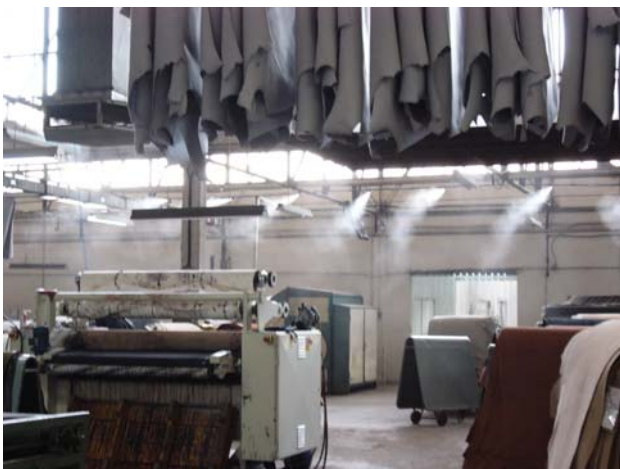
Visión general de uno de los 10 ramales porta-boquillas del aéreo de la instalación, humidificando el ambiente siempre sin mojar
