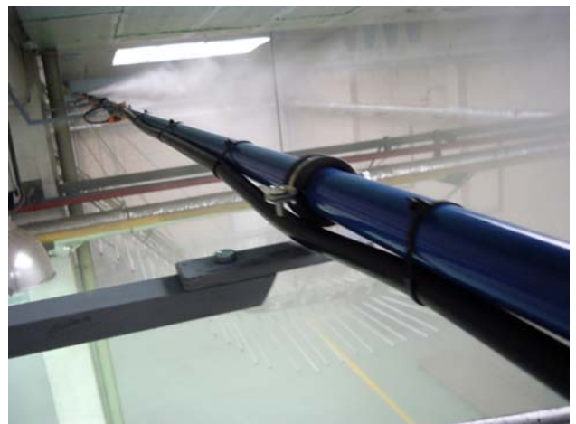
Detalle líneas porta-boquillas de aire y agua
