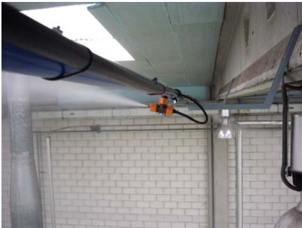
Detalle boquilla nebulización FICFOG funcionando
