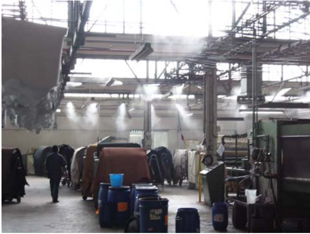
Visión general de la humidificación de la nave
