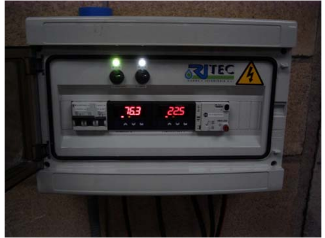
Programador que controla la activación-desactivación de la instalación
