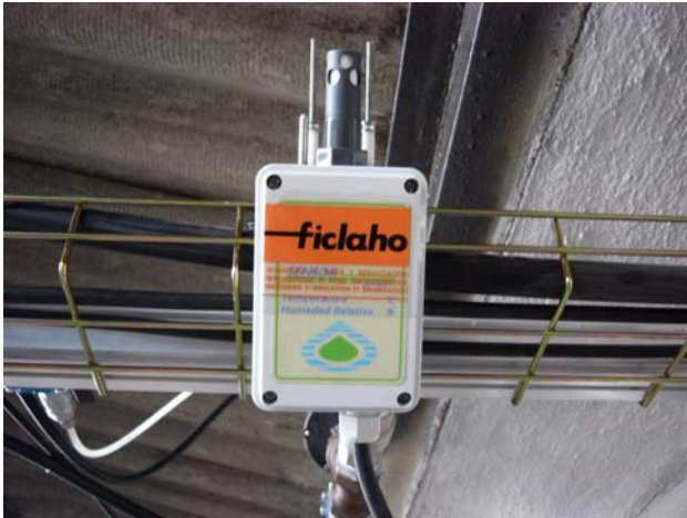
Detalle de la sonda de HR y Tª que controla la activación y desactivación del sistema
