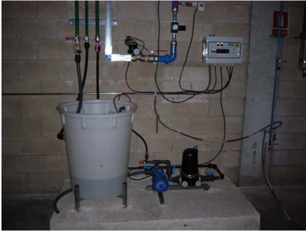
Detalle cabezal de la instalación (aire comprimido y líquido)
